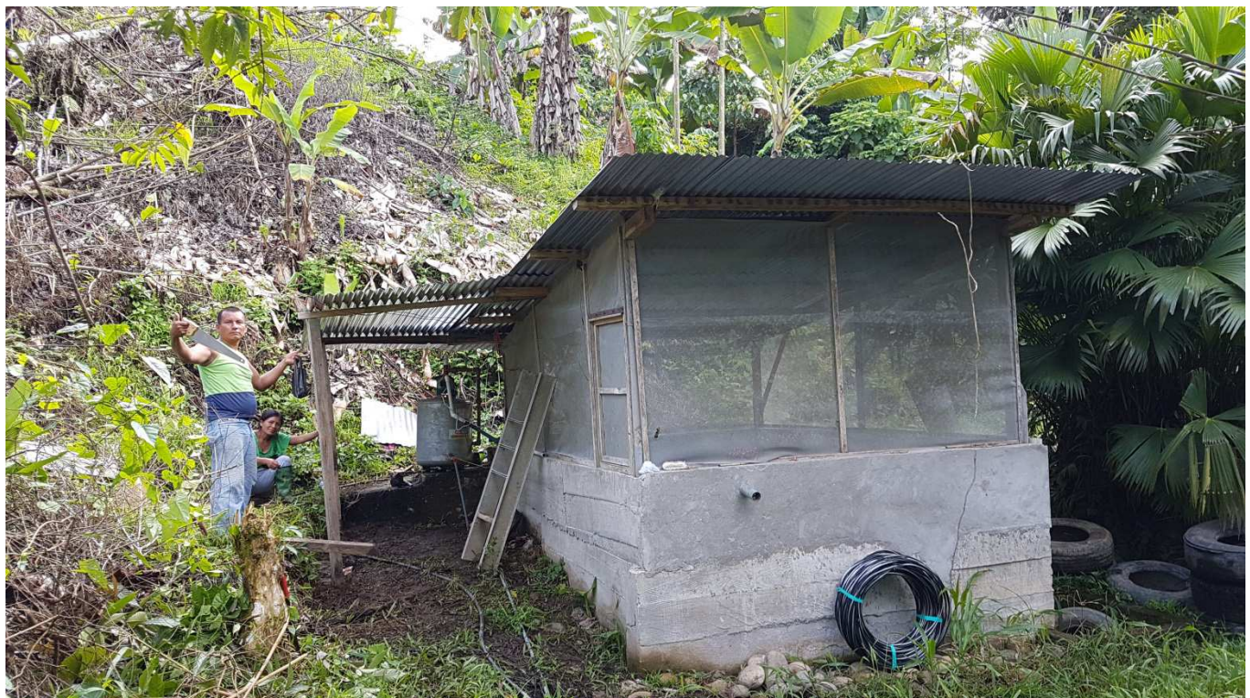
Wasserpumpe mit Überdachung und Wassertank
